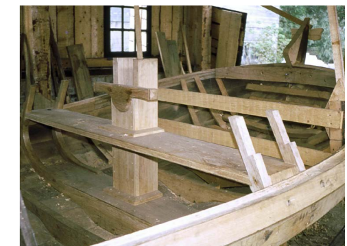
onder: De Else werd voorzien van een gelamineerd berghout en kreeg dito spanten
